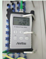
写真6: 光ファイバコードの不良による障害事例
