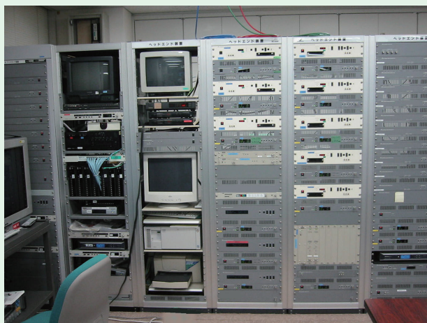
写真2: ケーブルテレビ局の典型的なラック
