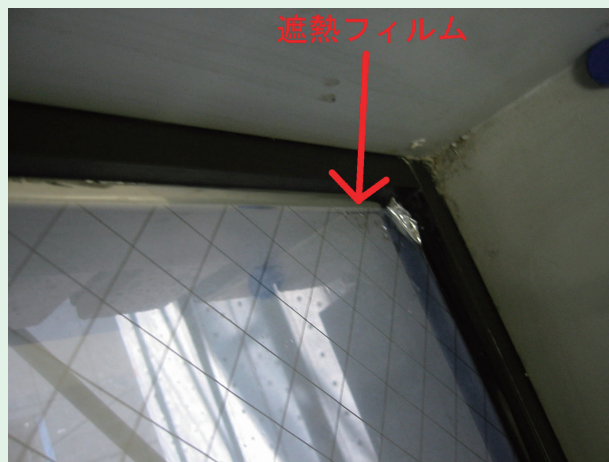
写真2: 遮熱フィルムを貼った網入りガラス
